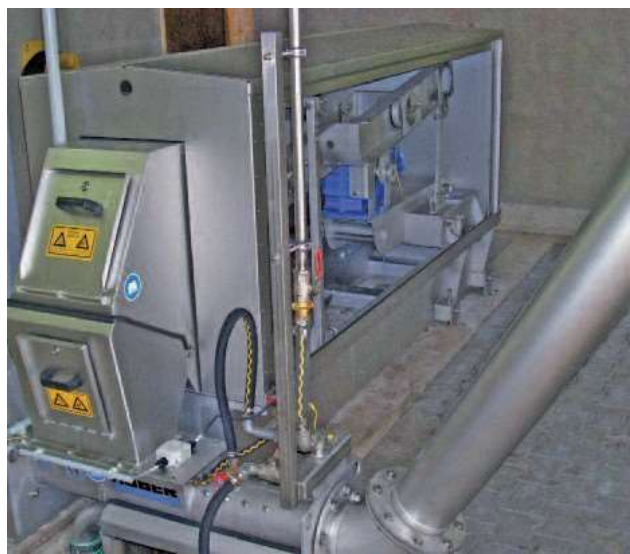
Монтаж в канал на HUBER Плоскоситовата ротационна решетка CurveMax® с включена след нея промивна преса
