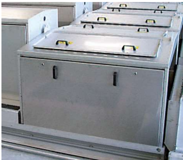
Няколко паралелно инсталирани HUBER Плоскоситови ротационни решетки CurveMax® с капак срещу неприятни миризми
