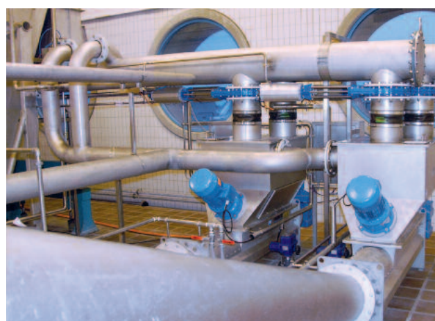
Redundante Schwemmrinnenbeschickung der HUBER Waschpressen WAP® SL
