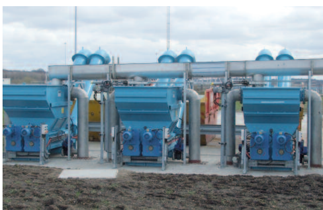
Kläranlage Knostrop (GB): 2 Millionen EW HUBER Schwemmrinne HLC: 20 m 3 Abwasser pro Sekunde
