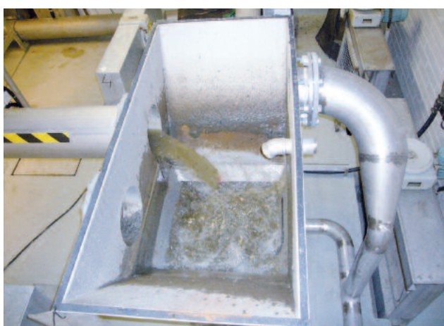
Transportwasser dient gleichzeitig als Waschwasser
