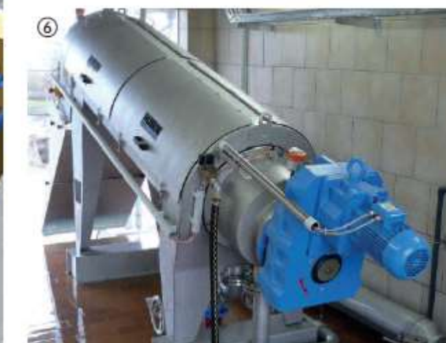
Обезводняване на утайки към третиране на излишна утайка СВ > 18%
