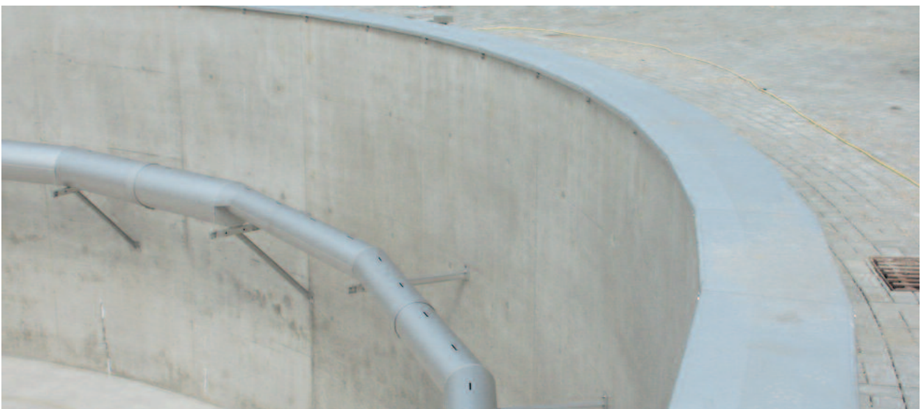
Beckenkronenabdeckung schützt die Laufbahn des Räumers
