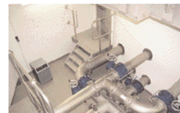
Прегледно разполагане на тръбопроводи
