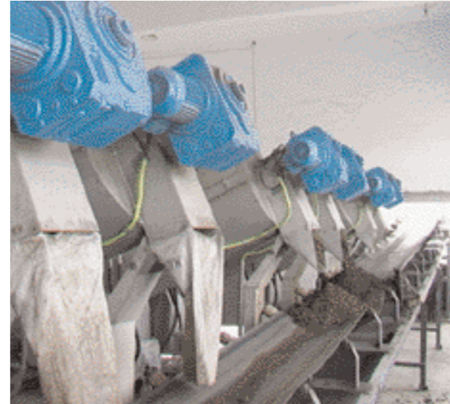
Фабрика за хартия Lingoang, Китай: Обезводняване на първичната/биологичната утайка до СВ > 28 % със съоръжение за обезводняване на утайки HUBER ROTAMAT® RoS 3
