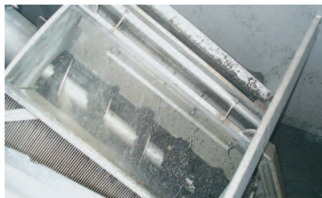
Im Rechenkorb werden Schwimm- und Schwebestoffe effektiv zurückgehalten. Durch die durchgreifenden Rechenzähne erfolgt eine Zwangsreinigung des Rechenkorbes
