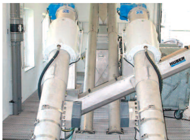
Unterirdische, redundante Ausführung der HUBER Kompaktanlage ROTAMAT® Ro5
