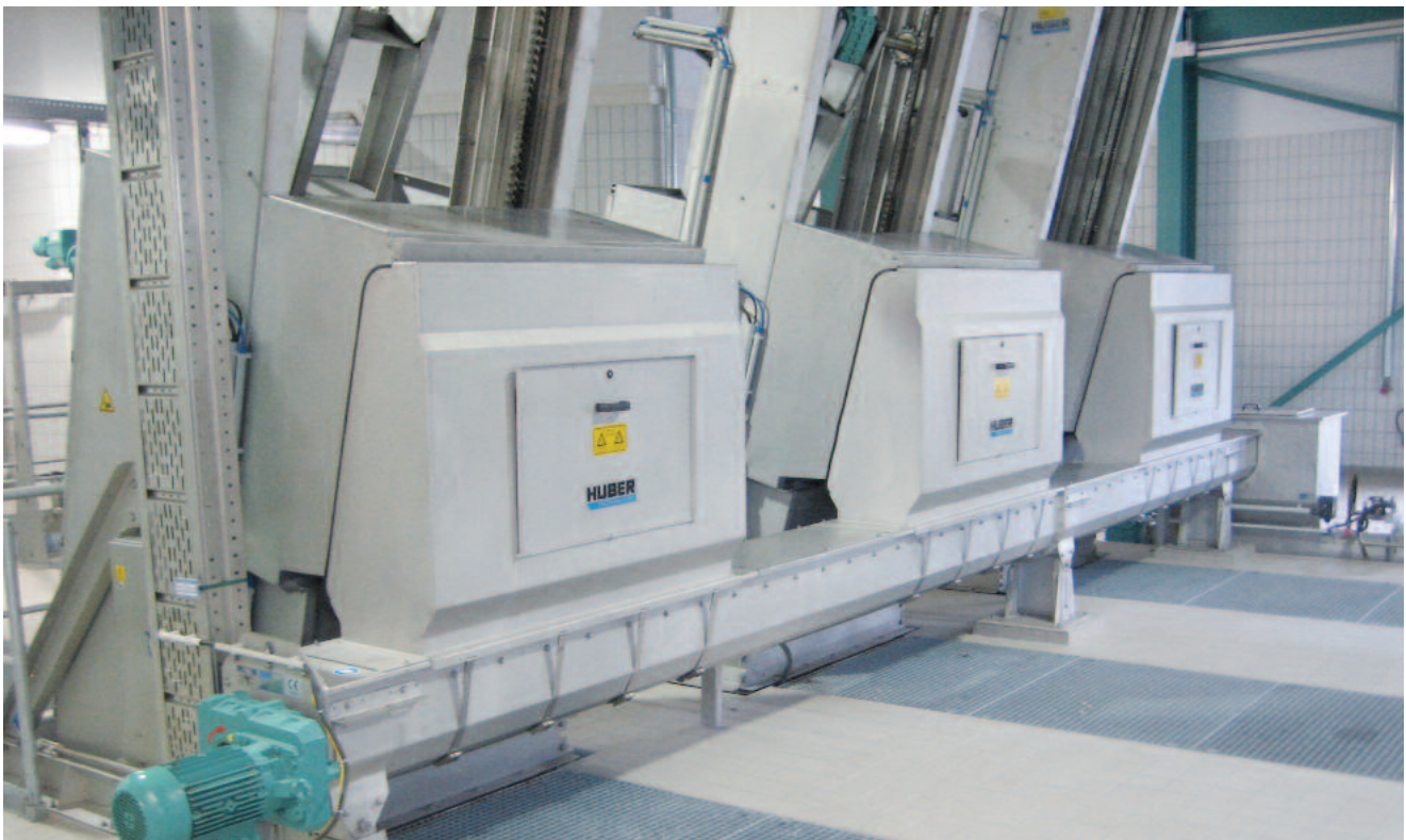
Drei Rechen werfen Rohrechengut in eine Trogförderschnecke Ro 8t
