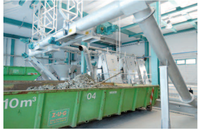
HUBER ROTAMAT® Rohrförderschnecke bei dem Abwurf von Rohrengut
