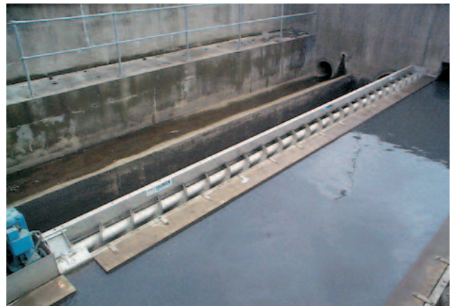
ROTAMAT® Siebanlage RoK 1 an einem Abschlagsbauwerk
