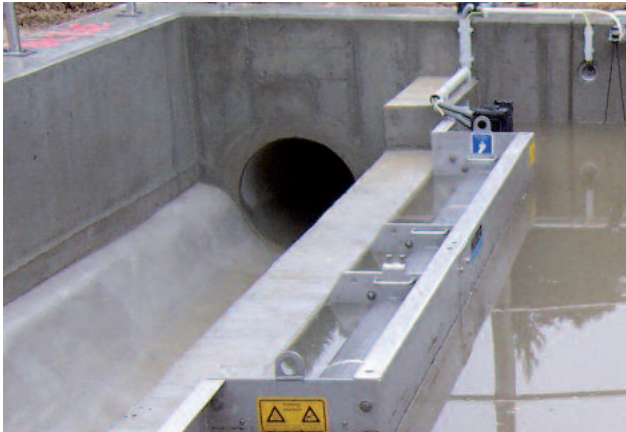
ROTAMAT® Siebanlage RoK 2 vor dem Entlastungsbeginn
