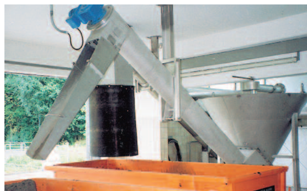
Eine Klassierschnecke transportiert das abgeschiedene Sandfangmaterial aus dem Abscheideraum in den Container.
