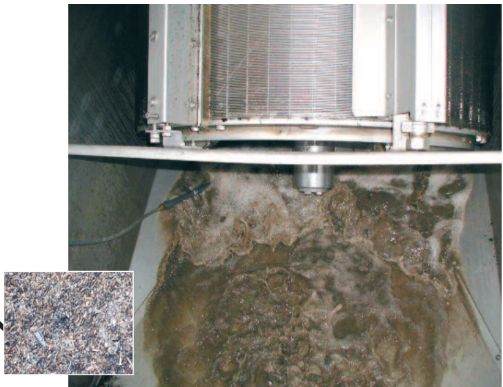
Absieben bei 1 mm und Entwässern (TR ca. 30%) der organischen Stoffe mit der HUBER Siebanlage ROTAMAT®.
