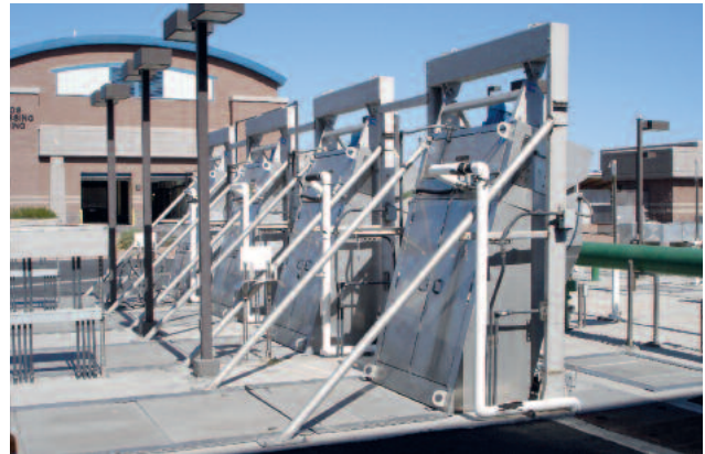
Vier HUBER Stufenrechen STEP SCREEN® SSV: Länge 5300, Breite 1376, Spaltweite 6 mm, Aufstellwinkel 75°. Höchste Betriebsstabilität durch speziell ausgebildete Bodenstufe zur Steigerung der Unempfindlichkeit gegenüber Sand, Splitt und Steinen.
