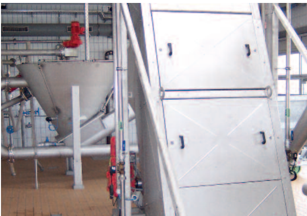
HUBER Stufenrechen STEP SCREEN® SSV im Gerinne ausschwenkbar ohne Demontage der nachgeschalteten HUBER Rechengutwaschpresse.
