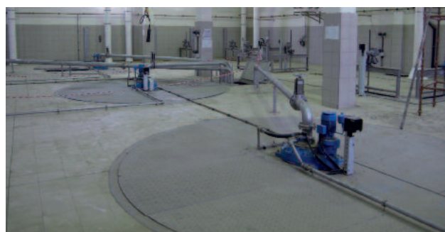
HUBER VORMAX vor der Inbetriebnahme
