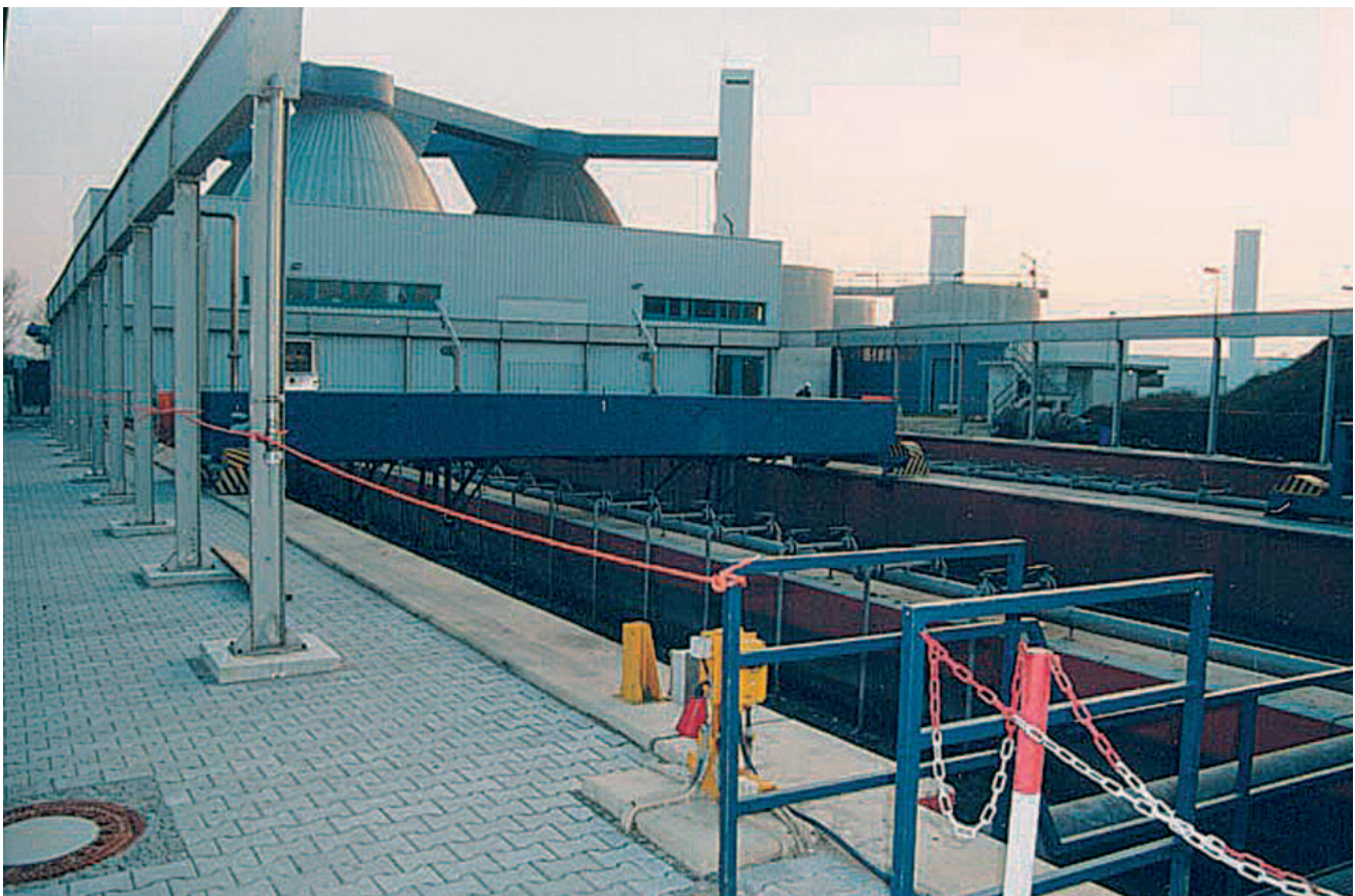
Typische Langsandfanganlage mit Saugräumer (Kläranlage Mannheim)
