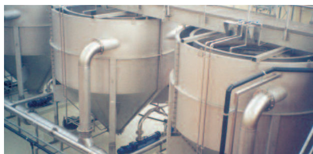
HUBER Rundsandfänge HRSF im Einsatz
