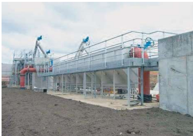
Надземен надлъжен пясъкоуловител ROTAMAT® Ro6 с включено отпред пресяване
