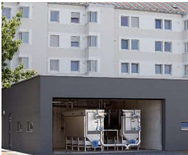
Отопителна централа с топлообменник HUBER RoWin
