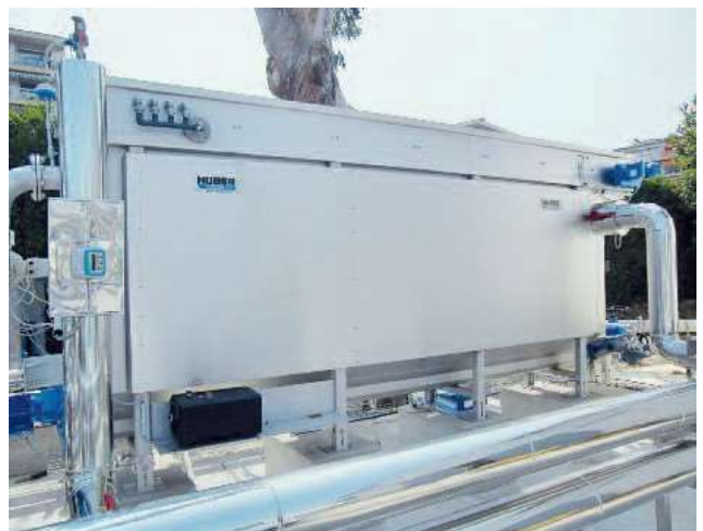
Охлаждане на хале за складиране; 120kW охлаждаелна мощност
