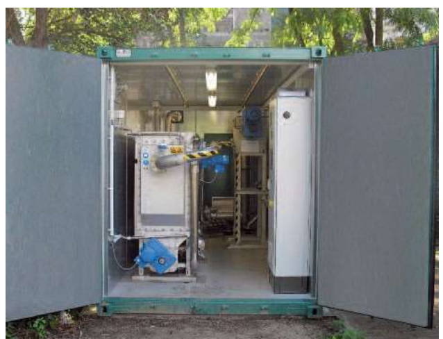
Пример за решение в контейнер; \approx 60 \text{ kW} отоплителна мощност; отопляване на спортна и дневна детска занималня
