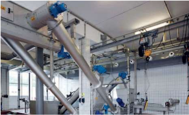
Промивна преса HUBER WAP-SL след сито HUBER ROTAMAT® Ro 2 с високотурбулентно промиване на отсятата маса за оптимална въглеродна възвращаемост
