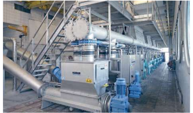
Редундантна експлоатация на промивни преси HUBER WAP-SL със захранване с воден улей. Комплексна система в капсуловано срещу миризми изпълнение от неръждаема стомана
