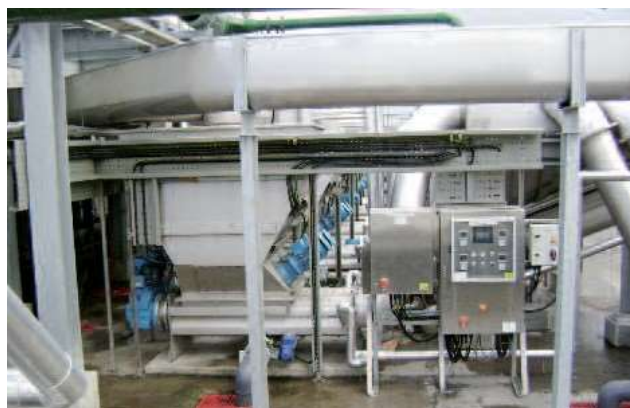
ПСОВ Дъблин (Ирландия): 2 милиона ЕЖ HUBER Воден улей HLC: 30 м 3 отпадъчна вода на секунда
