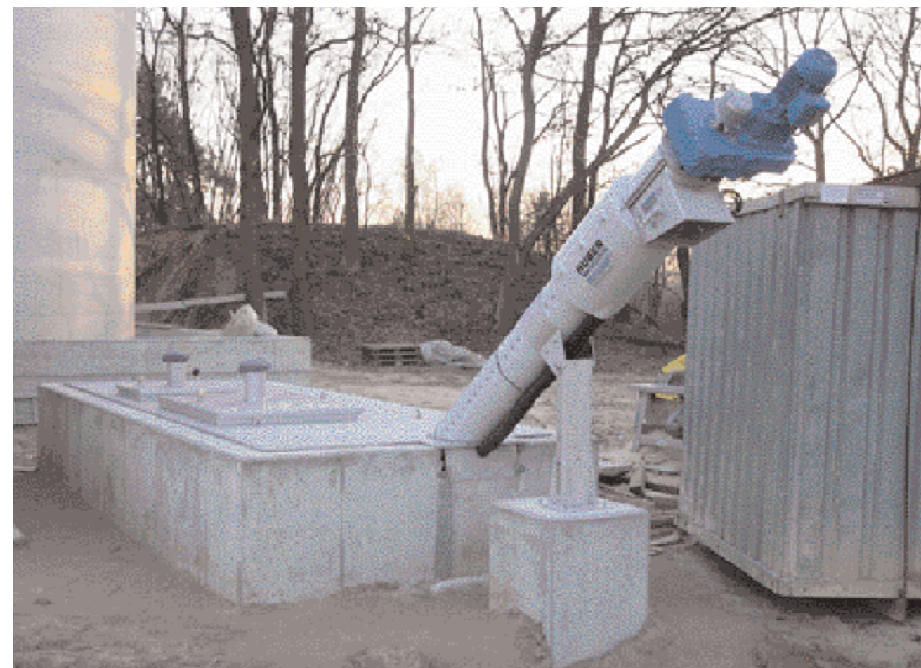
Пресяване на отпадъчни води монтирано в един изравнителен резервоар: фино сито HUBER ROTAMAT® Ro 2
