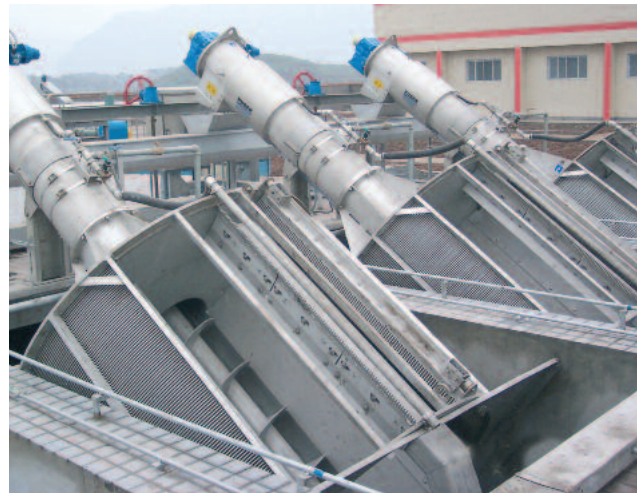
Mehrere parallel geschaltete HUBER Feinstrechen ROTAMAT® Ro1 direkt in das Gerinne eingebaut
