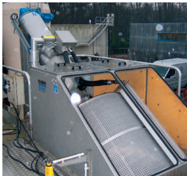
Installation im Freien mit Abdeckung und wärmegeämmter Spritzwasserleitung
