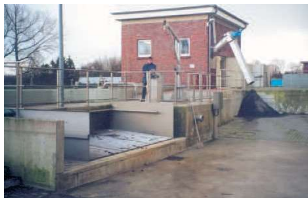
Не са проблем големи дистанции между бункер и съоръжение за промиване на пясък
