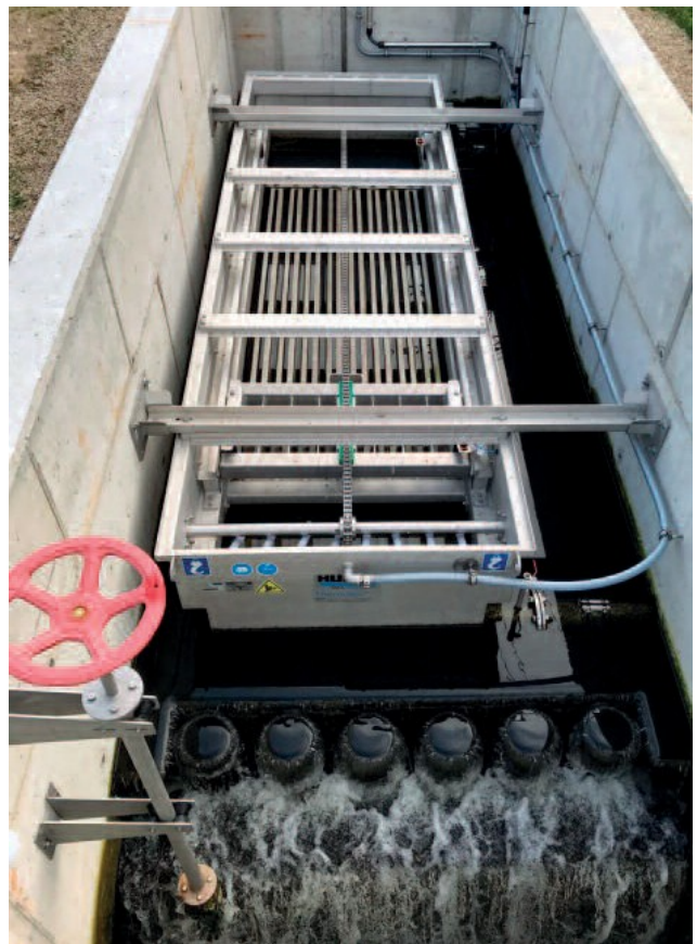
Поток на изход ПСОВ; 1x RoWin C8; без предварително пресяване, терм.мощност на извличане 500 kW – свободно охлаждане без термopомпа
