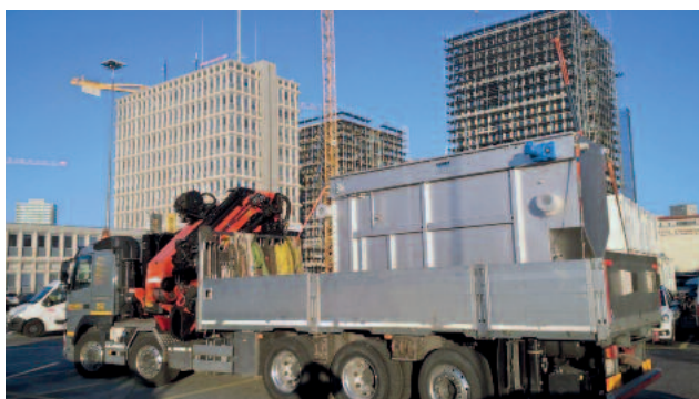
Kommunales Abwasser; 1x RoWin C8; ohne Vorsiebung therm. Entzugsleistung bis zu 500 kW
