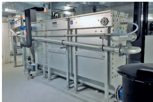
Grundlast Skiessort; 1x RoWin 4; Vorsiebung über HUBER WAP® L4; therm. Entzugsleistung 150 kW
