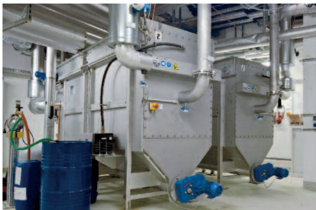
Kommunales Abwasser; 2x RoWin 8; therm. Entzugsleistung 560 kW Heizen / 1.000 kW Kühlen
