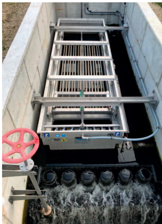
Kläranlagenablauf; 1x RoWin C8; ohne Vorsiebung therm. Entzugsleistung 500 kW – freies Kühlen ohne Wärmepumpe
