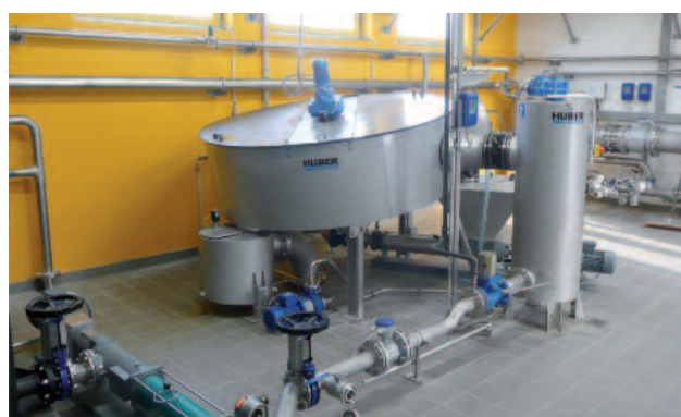
Filtratvorlage und Spritzwasserpumpe für Wasserkreislauf
