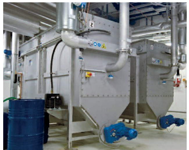
Битова отпадъчна вода; 2x RoWin BG8; терм.мощност на извличане 560 kW отопляване / 1.000 kW охлаждаване
