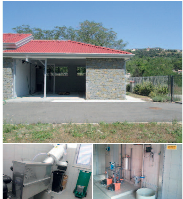
HUBER BioMem® Kompaktkläranlage in Roc, Kroatien
